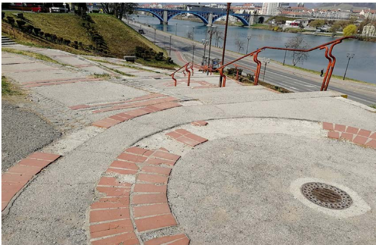
Slika 3: Poškodovana pešpot v soseski Greenwich v Mariboru
